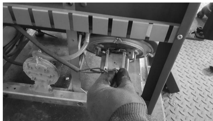
Cables de conexión
