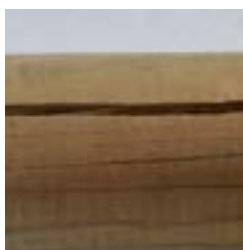
Cracks/Grietas/Fente/Risse/ Crepe/ Barsten/Fendas
